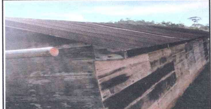
Foto 4: Se cambiara la tabla esta rajado por la lluvia.
