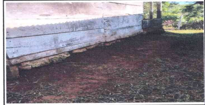
Foto 6: Se observa las paredes dañados moho.
